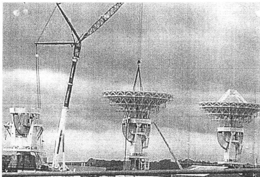
L'installazione delle antenne satellitari all'interno della base della Marina Usa
